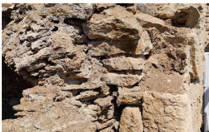
Φωτογραφία 16. Ενδεικτική εικόνα της κατάστασης διατήρησης του θόλου και της εισόδου («μπούκας») του εξωτερικού φούρνου (Τμήμα 3)
